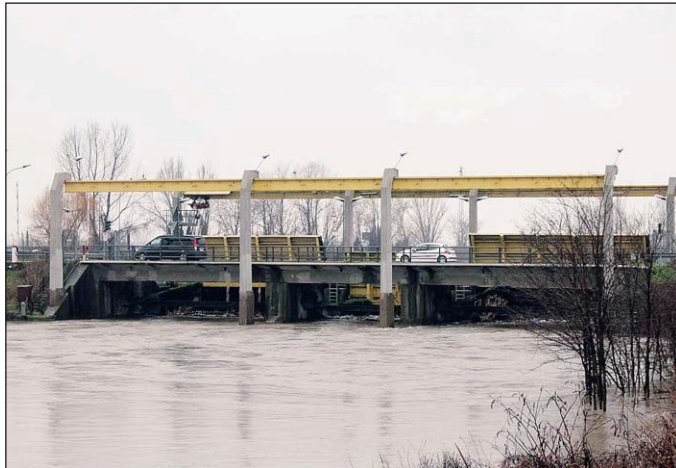
Bonifica In questi giorni di maltempo l'attività del Consorzio è stata fondamentale per regolare i corsi d'acqua. Nella foto, lo sbarramento sul Canalbianco tra Frassinelle e Arquà
